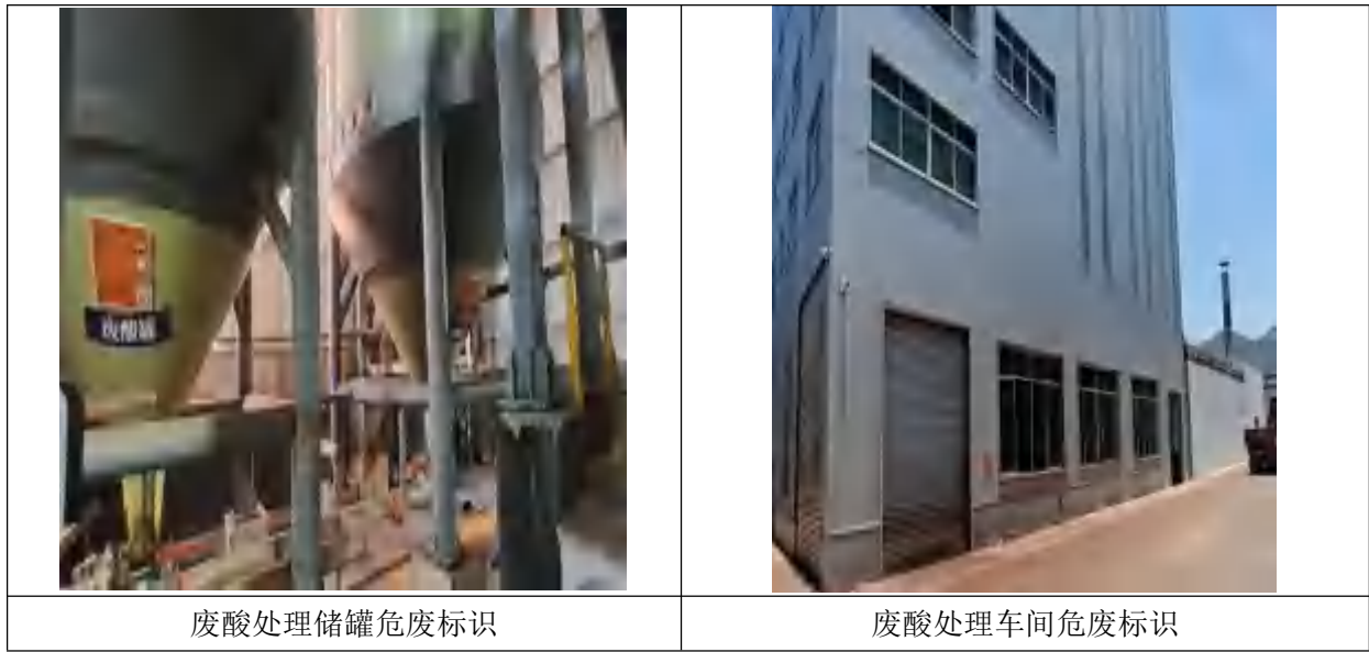
图 4.1-5 危险废物收集设施照片
